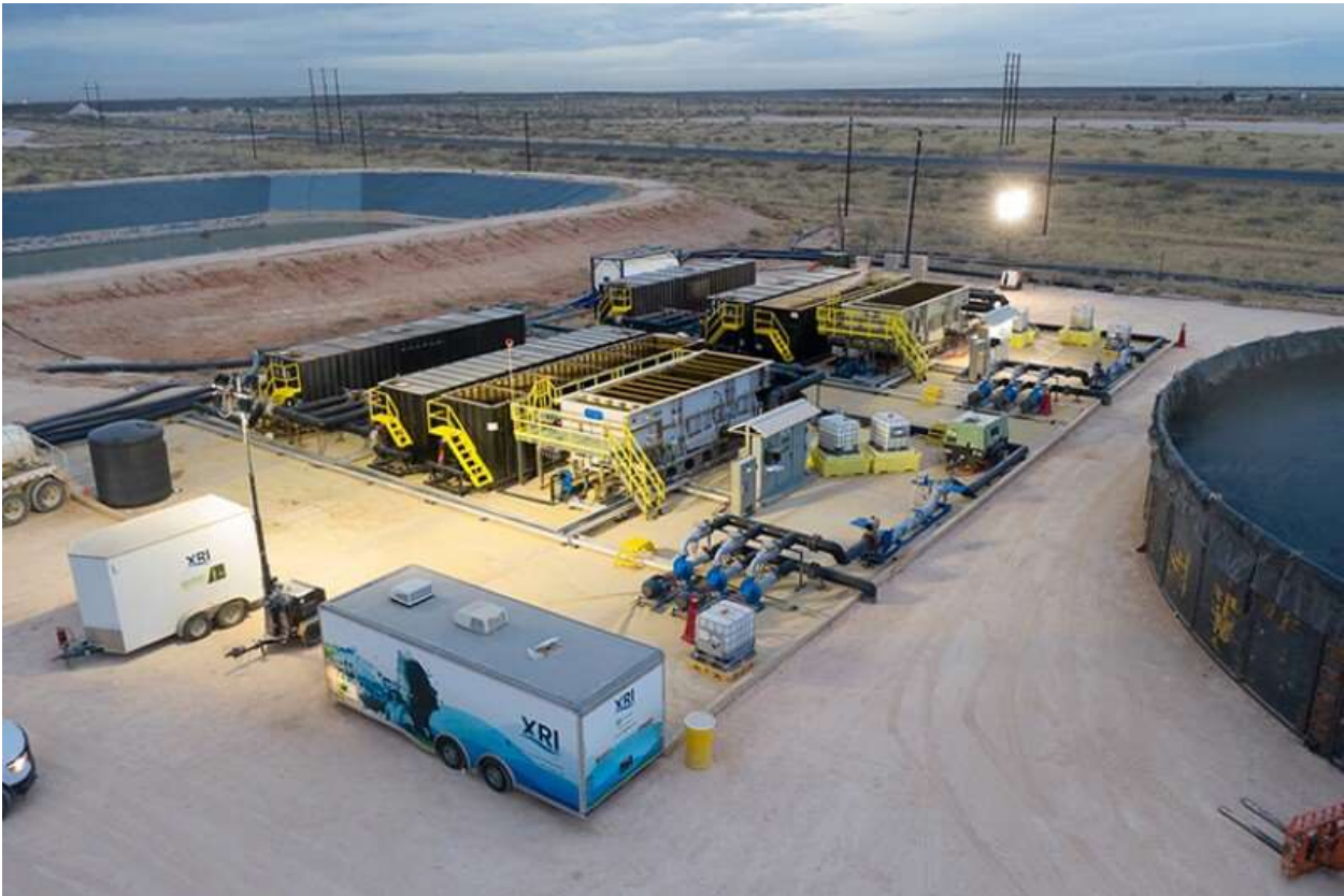
Una vista aérea de una instalación de reciclaje de agua XRI en la cuenca del Pérmico. Fuente: XRI.
